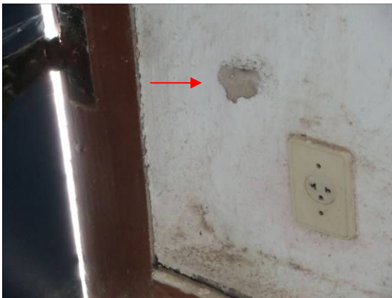
Figura 4: Ponto P4 no cômodo 03. Aproveitando pequenas perdas de tinta provocadas por abrasão, foram feitas prospecções nessa parede para identificação de camadas de argamassa de cimento.
