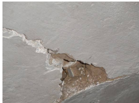
Figura 7: Detalhe do P7, onde se observa a existência dos dois materiais, à esq. superior cimento e ao lado alvenaria de terra, podendo ser pau-a-pique.
