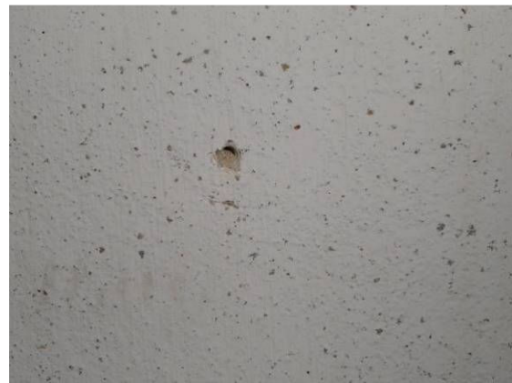
Figura 5: Ponto P5, no peitoril da janela do cômodo 02, foi encontrada argamassa de cimento e pintura diretamente sobre esta.
