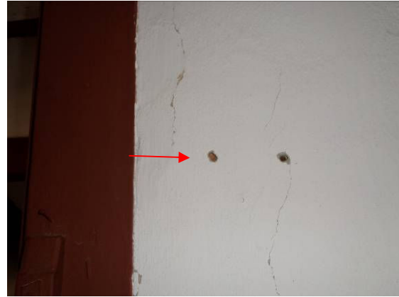
Figura 3: Detalhe dos Pontos P2eP3 no cômodo 02. A prospecção revelou um esteio de madeira, interno ao reboco e traços de argamassa de cimento. Nota-se que a mescla de materiais está causando trincas superficiais na camada de reboco.
