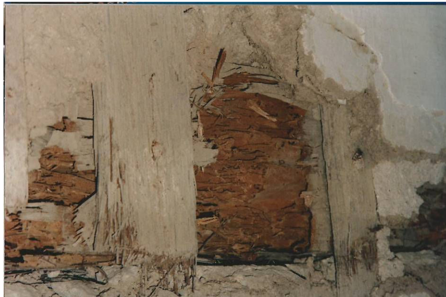
Figura 20: Foto tirada durante a intervenção, no ano de 1982. Detalhe do pau-a-pique totalmente atacado por térmitas. (Fonte: Arquivo Museu Regional de Caeté, 1982).
