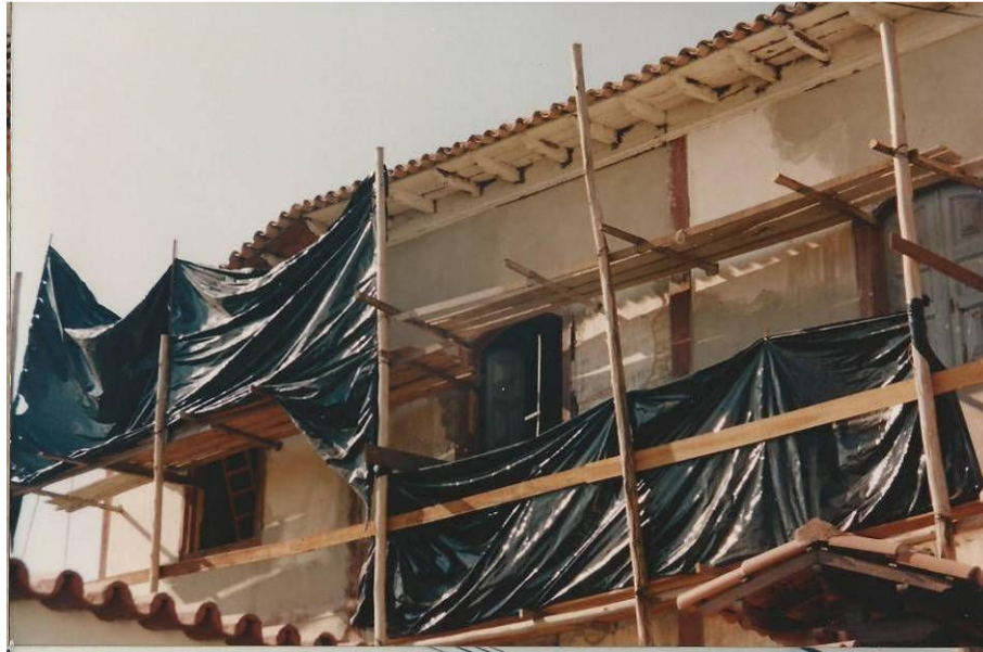
Figura 16: Foto tirada durante a intervenção, no ano de 1982. Vista da fachada noroeste. Nota-se a substituição do reboco tradicional por reboco em argamassa de cimento, porém, mantendo trechos das paredes originais ou antigas. Também se observa a substituição de paredes de adobe ou pau-a-pique, por tijolos cerâmicos maciços. (Fonte: Arquivo Museu Regional de Caeté, 1982).
