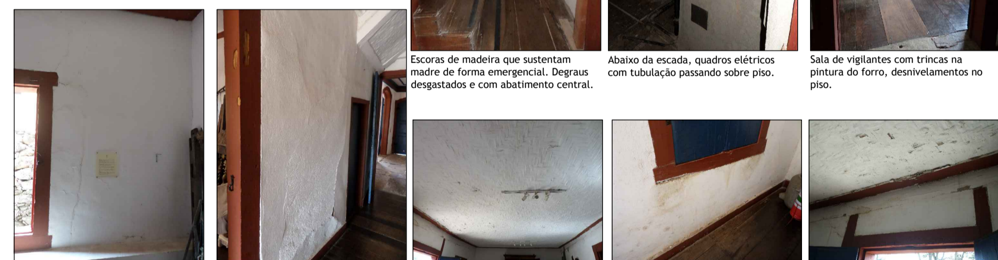
Trincas estruturais no ponto onde se localiza um estêo, na parede externa.
