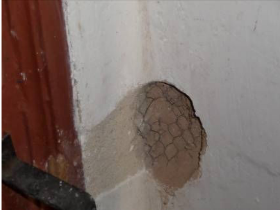
Figura 8: Ponto P8, no hall de entrada, atrás da porta, aproveitando desprendimento causado por barra de fechamento da porta, se observa a alvenaria de adobe, com reboco de argamassa de cimento, o qual foi assentado sobre tela de galinheiro. O uso desta técnica já é proveniente de ação restaurativa, ainda que o uso do cimento não seja mais considerado adequado.
