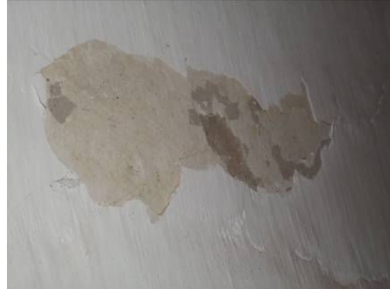
Figura 9: Ponto P9, na parede da escada que leva ao 2º pavimento. Desprendimento da camada de pintura revela camadas de reboco em cal e em cimento. No trecho em que essa parede aparece sem reboco na zona de visita ao telhado se observa que está executada em pau-a-pique e tijolos cerâmicos maciços.
