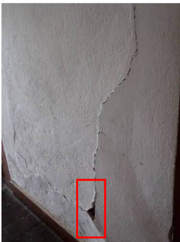
Figura 6: Ponto P6, trinca no corredor do 1º Pavimento, causada por incompatibilidade entre o reboco em argamassa à base de cimento e a
