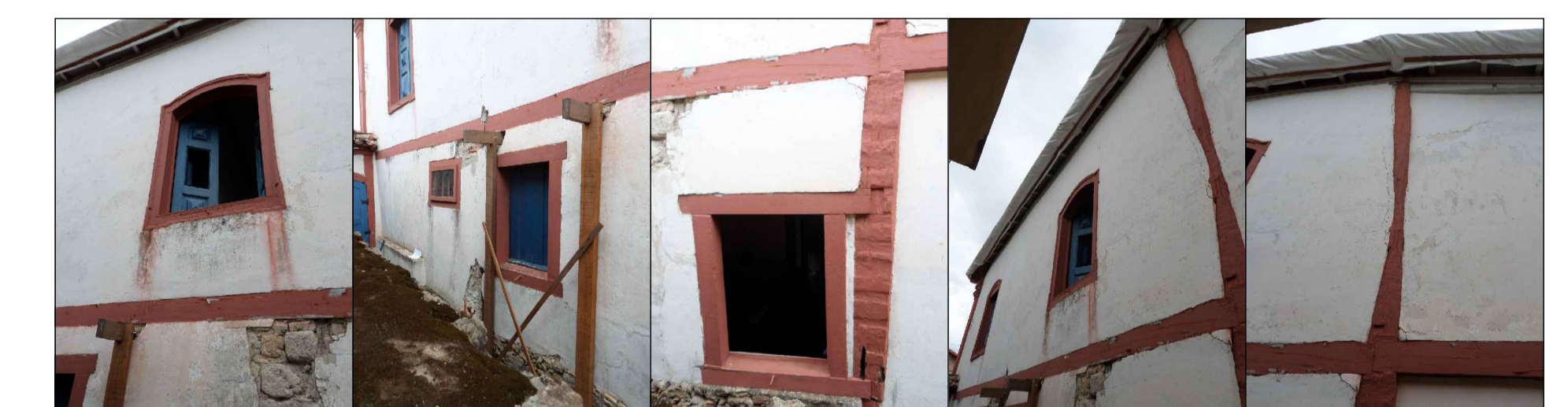
Parede com infiltrações, crosta negra, desprendimento de argamassa, causados pelo abatimento da estrutura de madeiras e estêos, que também gerou flexão nas paredes, com trincas e perdas de revestimento.
